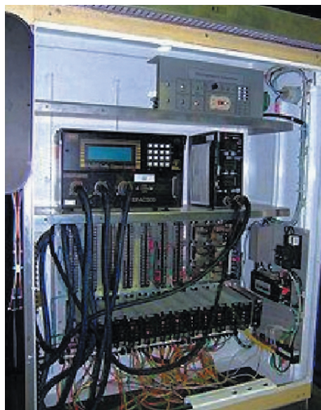
Рис. 5. Шкаф с ДК на Тайване
