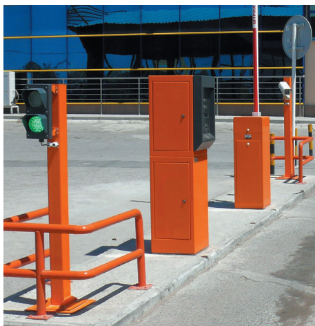
Рис. 7. Автоматический пункт пропуска на парковку
