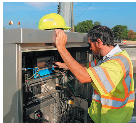
Рис. 6. Обновление ПО ДК инженером по системам сигнализации департамента транспорта штата Индиана (США)
